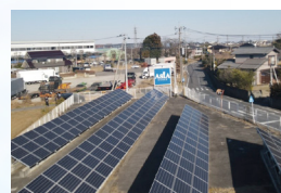
太陽光発電所
